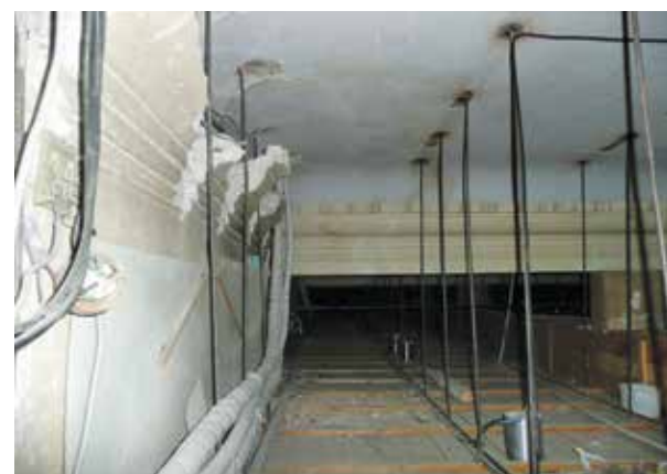
سقف کاذب الحاقی و پنهان شدن گچبری‌های سقف و تیرها
